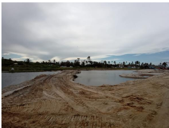
Figura 6: Um dos trechos de estrada recortando o rio e a lagoa do Cauípe, com compactação do solo. Aterro 3.
